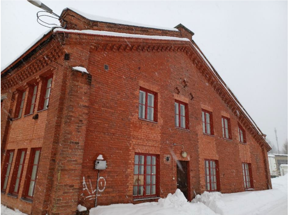
Kuva 40. Rakennuksen länsipääty ja vanhin osa, jossa on tehty eniten muutoksia. Vanhoja aukoksia on muurattu umpeen, päätyyn on rakennettu ovi ja ikkunoita on pienennetty.
