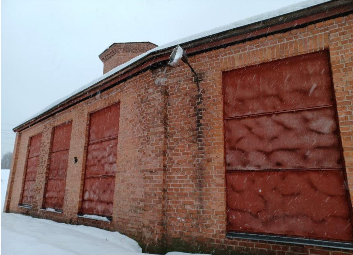
Kuva 43. Laajennusosan ikkunat on peitetty ilkeivällä vuoksi.
