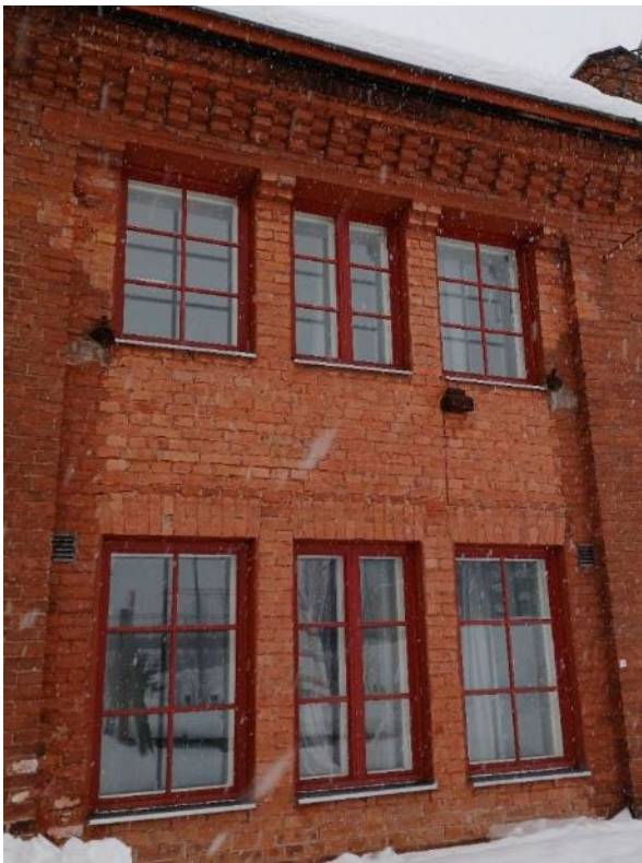
Kuva 57. Toimistopäädyn ikkunat sisäpihan puolella. Ikkunoiden paikalla oli alun perin ensimmäisen veturitallin ovet. Muutos on tehty todennäköisesti 1940-luvun lopulla.
